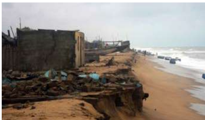
Forte érosion sur le lido de Grand Popo (source antenne nationale MOLOA du Bénin)
