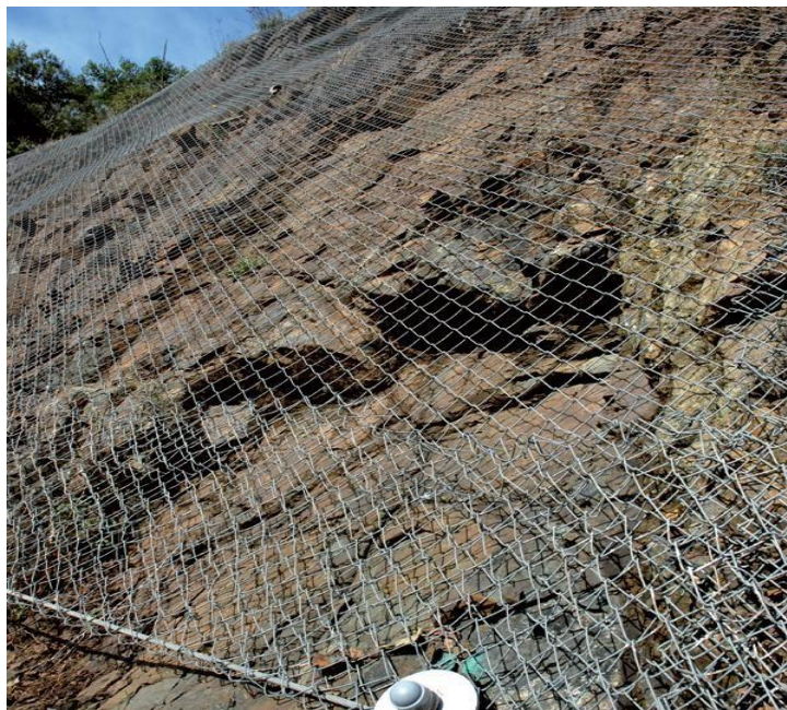
Photo 11 : Exemple de falaise aménagée avec un grillage plaqué
