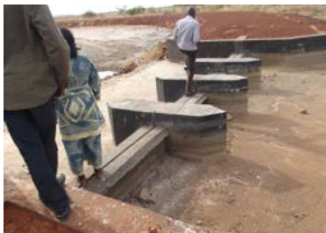
Digue anti-sel de Joal (source antenne nationale MOLOA Sénégal)
