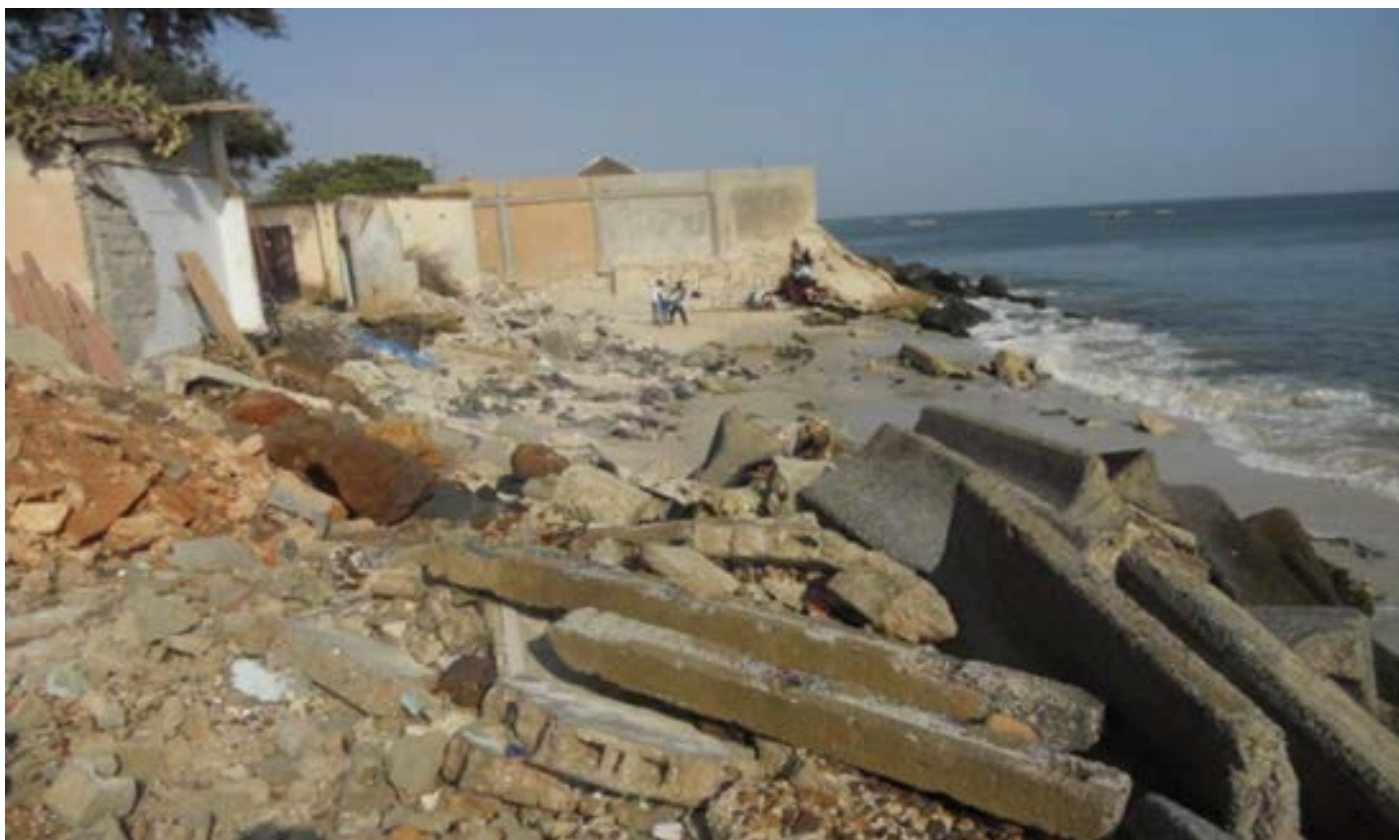
Forte érosion à Mbao en mai 2014 (source : antenne nationale MOLOA du Sénégal)
