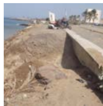
L'érosion des formations de la corniche est largement dépendante de la gestion des eaux pluviales (source antenne nationale MOLOA Sénégal)
