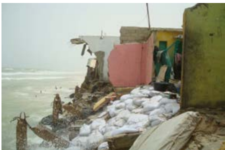
Effondrement de maisons à Guet Ndar suite aux agressions des vagues
