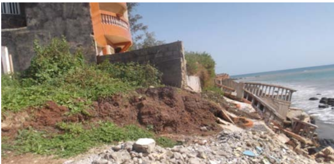
Destruction de maison à Yene (source antenne nationale MOLOA Sénégal)
