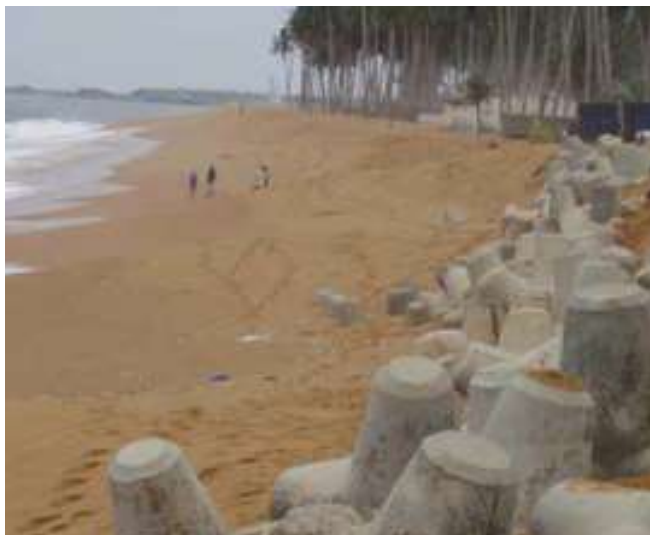
Lignes de tétrapodes placés en avant d'un mur de protection devant le Coco Beach. Port-Bouët, Abidjan (octobre 2003). Source: rapport étude de cas SDLAO détaillée, Côte d'Ivoire).
