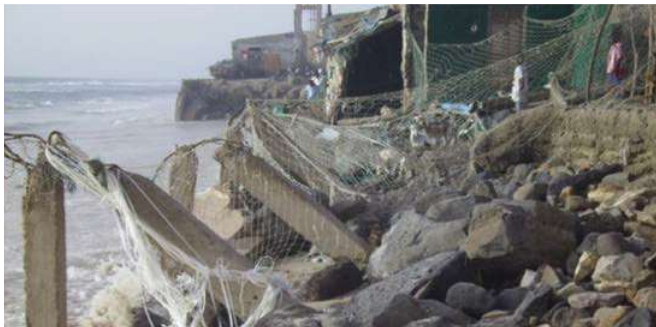
Eroulement du mur de protection à Guet Ndar (construit en 1910 et déjà largement affaissé). Image mars 2010, Leïdi (source ; étude de cas).
