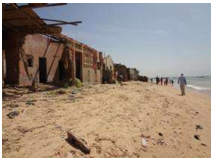
Destruction d'habitations à Mbour (source antenne nationale MOLOA – Sénégal)
