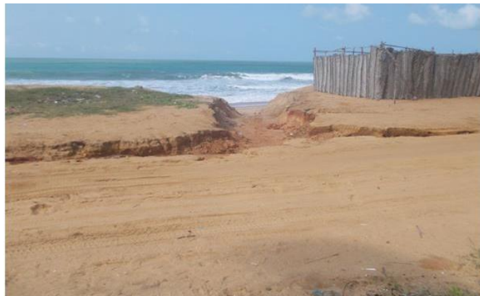
Figure 4.6 Photo montrant la proximité du rivage de la Route des Pêches ravinée à Bah (cliché Laïbi, 2015).
