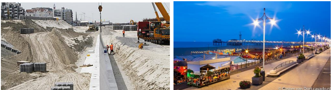
Figure 5.5 Exemple de combinaison entre protection maximale et valorisation du front de mer : construction d'une nouvelle digue de protection de 1 km au boulevard Schevingen, la Haye, Pays-Bas (photo : DutchWaterSector.com).
