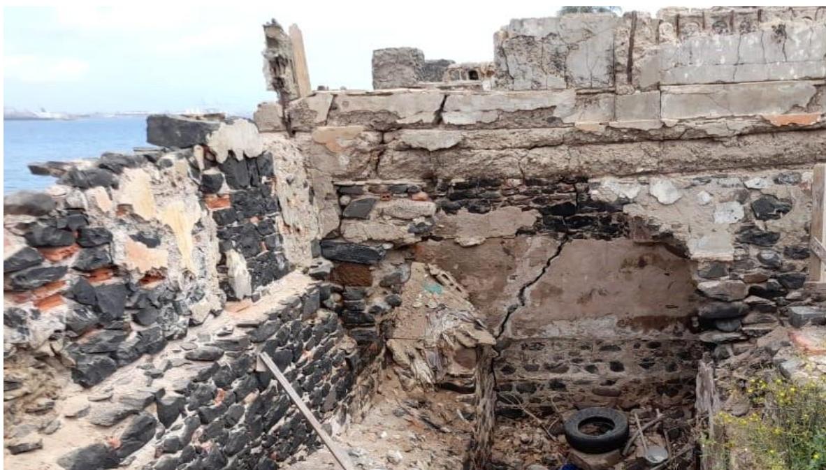
Photo 2: Effondrement du mur protection au niveau de la Mairie de Gorée
