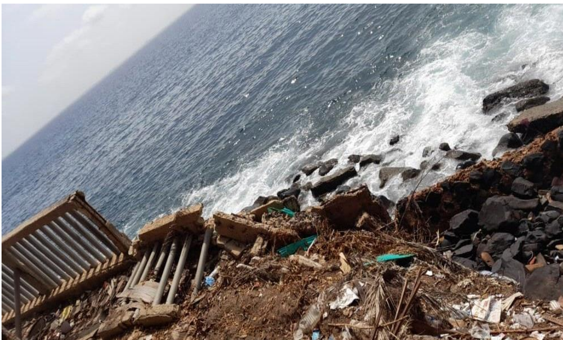
Photo 4: Effondrement du mur de protection de la maison d'Education Mariama Ba
